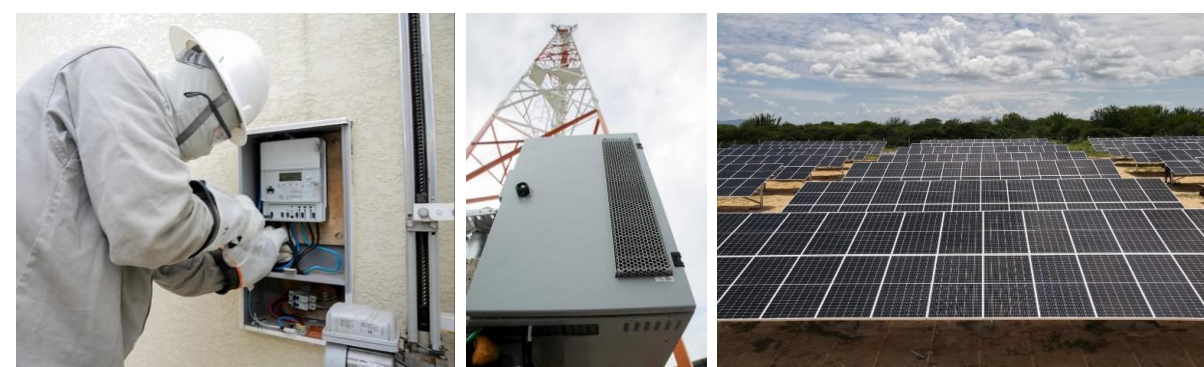
DSO Atibaia. Microrredes. LTE Privado
